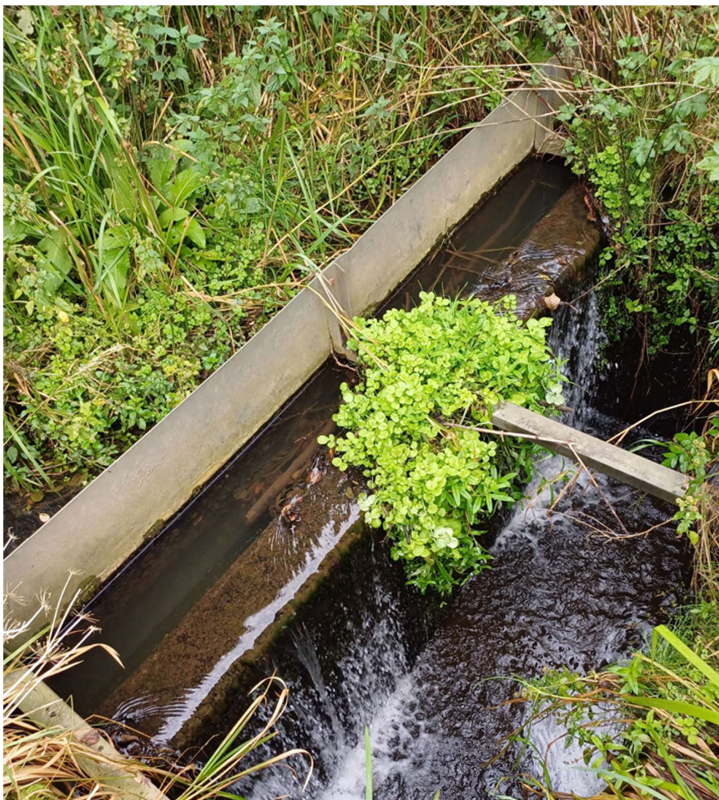
Figur 2: Bygværket i regnvandsbassinet med overfaldskant, som vandløbet løber henover. Vandløbet kommer ind fra venstre, løber over betonkanten og videre i rør efter styrtet. Styrtet er på ca. 1,5 meter.
